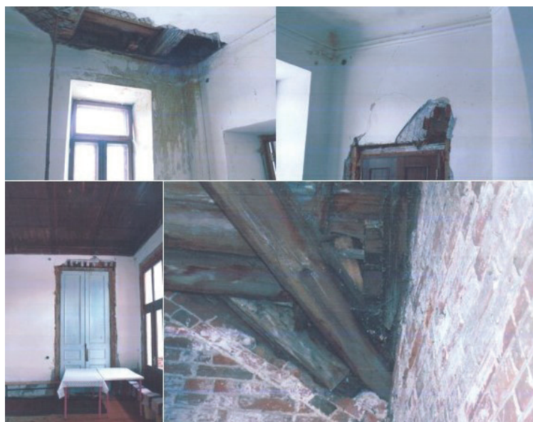
Рис. 1. Основные виды разрушений Усадьбы [12]
