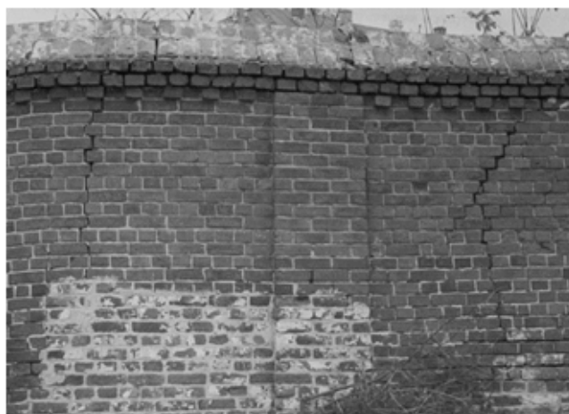
Рис. 1. Разрушение стен, огораживающих территорию Иоанно-Предтеченского монастыря
